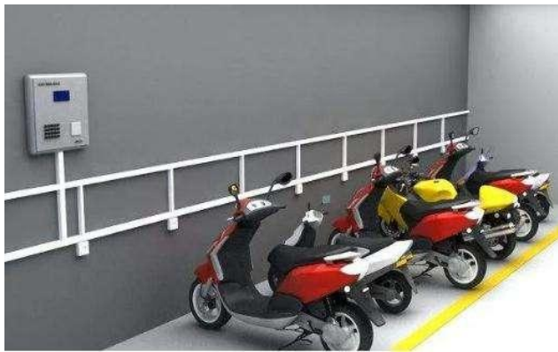
非机动车充电设施
