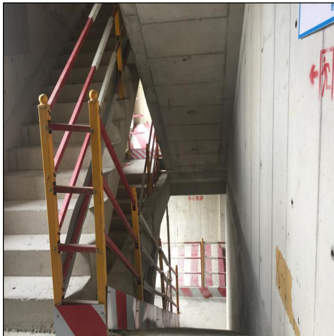
楼梯间工具式防护栏杆
