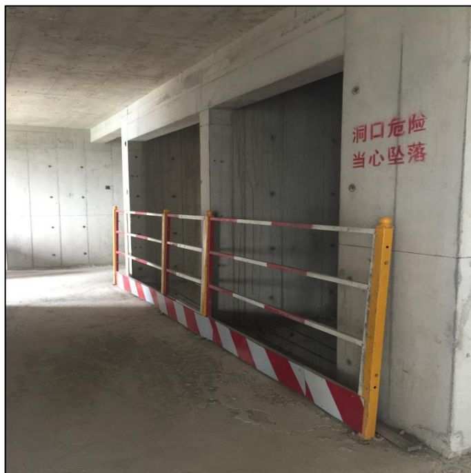
楼层、电梯井工具式临边防护
