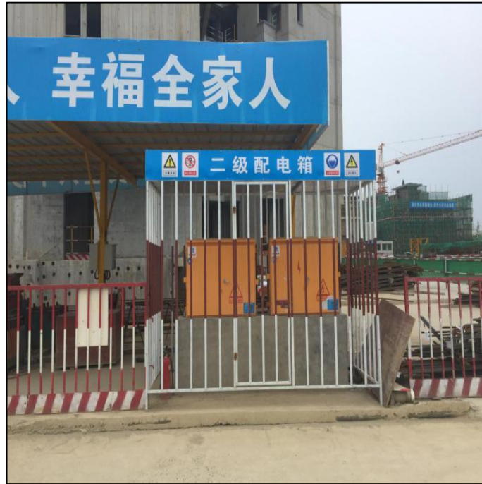
二级配电箱工具式防护
