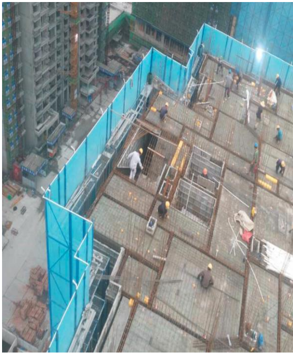
爬架喷淋系统，可重复使用，可有效治理扬尘
