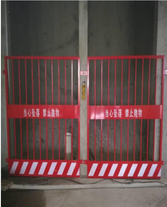
电梯井竖向防护门
