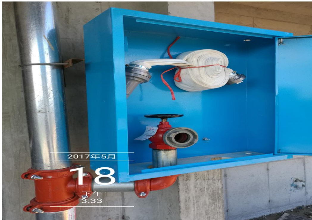
各楼层消火栓箱固定牢固，箱内配置水枪水带
